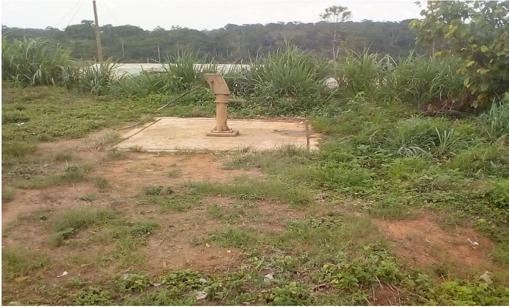
Photo 2 : Forage non fonctionnel derrière la Mairie de BIKOK
