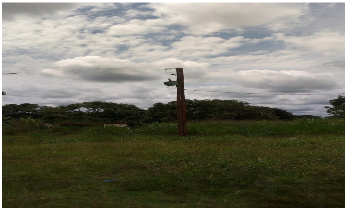
Photo 6 : du transformateur au centre de BIKOK
